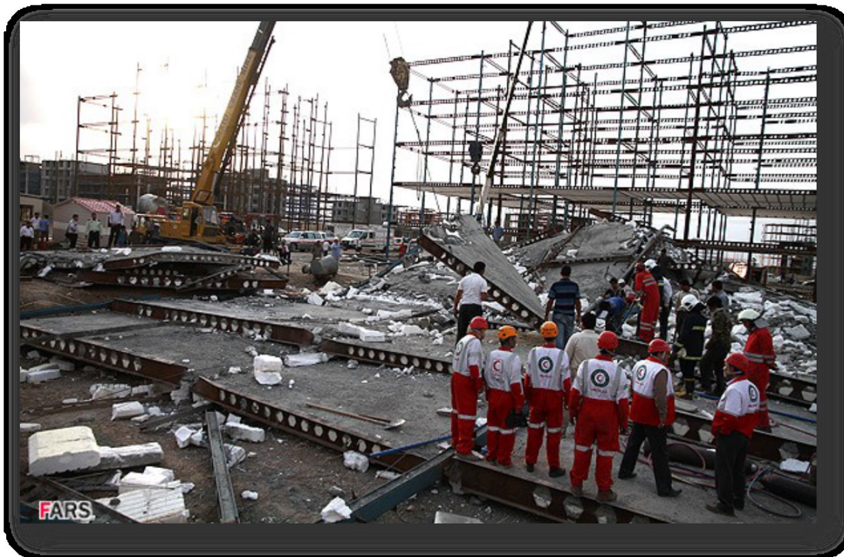
شکل (۲۲) اجرای سقف بدون اجرای دیوار برشی باعث ناپایداری و فروریزش ساختمان شده است.
